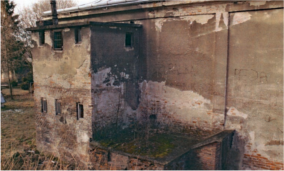
Zniszczenia Polskiego Domu Katolickiego – strona wschodnia (APŻ)
